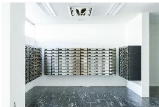
<宅配ボックス>
